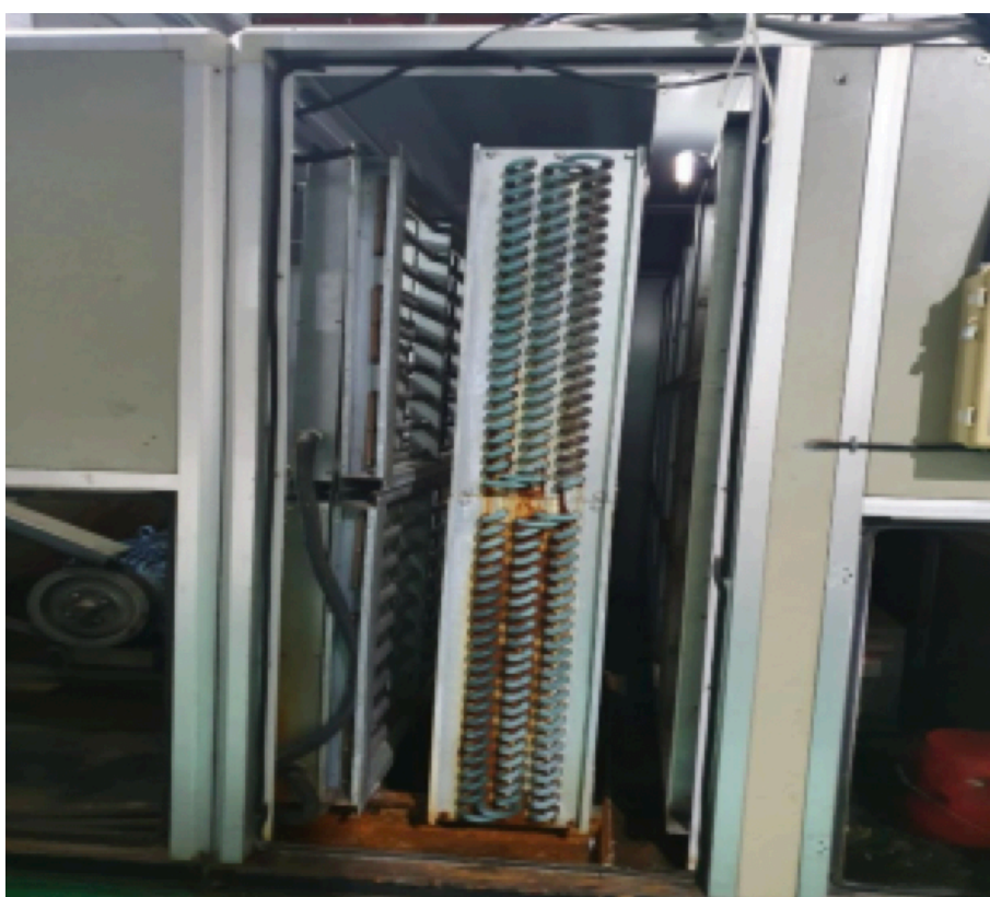
Heat-Pipe Pre Cooling System 설치 전
