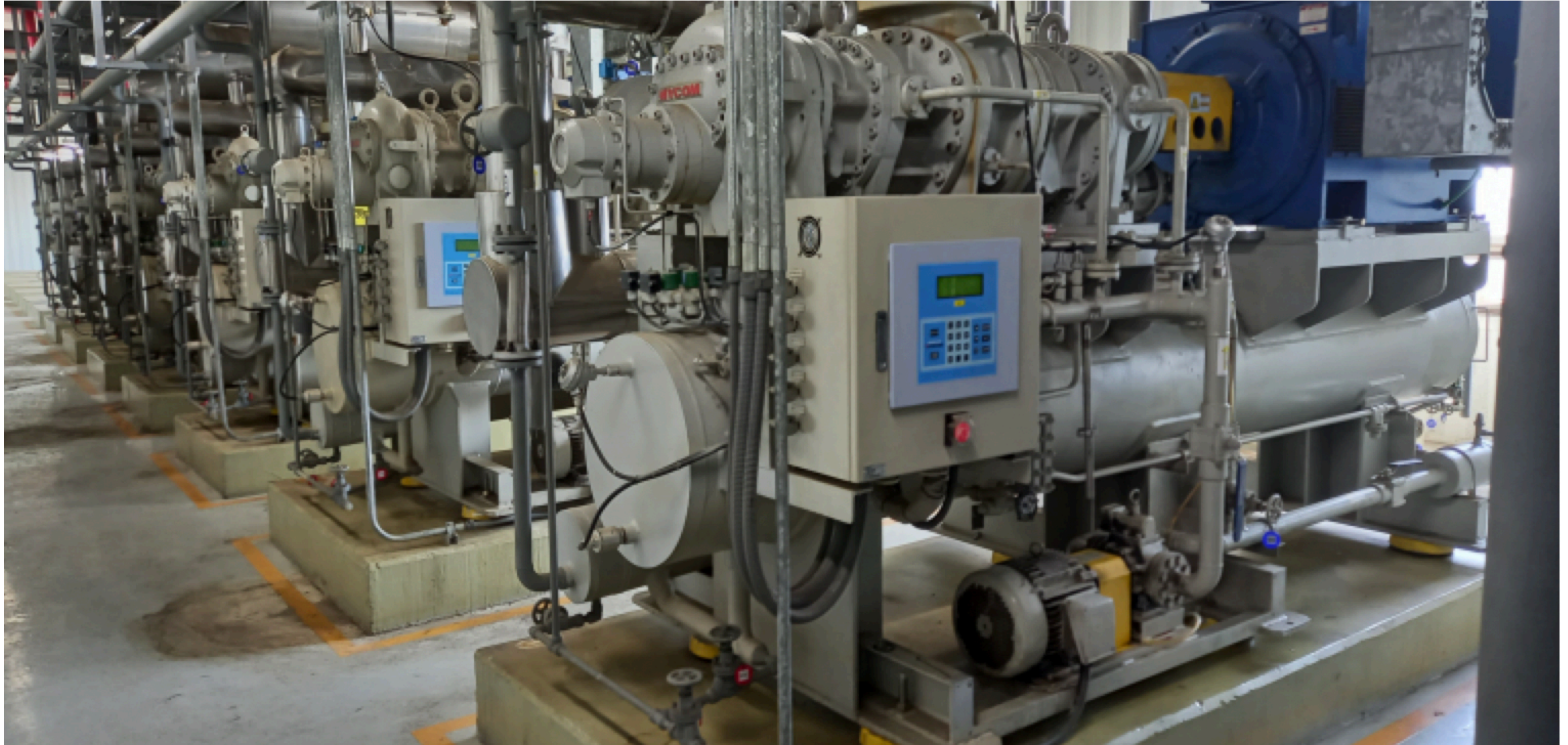
[图3-1]氨冷冻机现场照片
